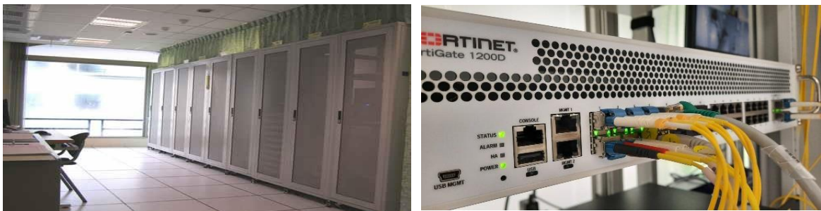
圖 2-2-13: 電腦機房/圖 2-2-14 防火牆網路區隔
